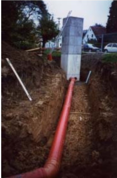
Abbildung 10: Ansaugturm und ein PVC-Rohr. Die acht parallelen PVC-Rohre weisen eine Nennweite von 400 mm auf. Die Verlegetiefe der Rohre beträgt im Mittel 2 m.
