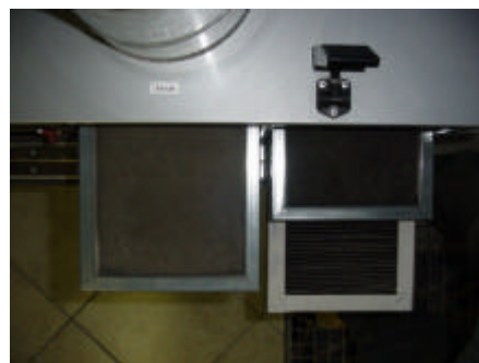
Abbildung 11: Lüftungsgerät mit einer Kombination aus Matten- und Kassettenfilter im Zuluftstrang (rechts) sowie einem einfachen Mattenfilter in Abluftbereich (links)
