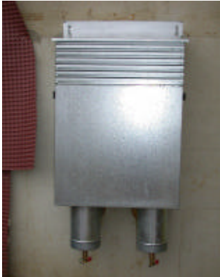
Abbildung 5: Frischluftansaugung – Ansaugfilterkasten mit Feinstaubfilter F6 in Taschenfilterausführung
