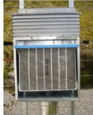
Abbildung 7: Frischluftansaugung – Ansaugfilterkasten mit Feinstaubfilter F6 in Taschenfilterausführung
