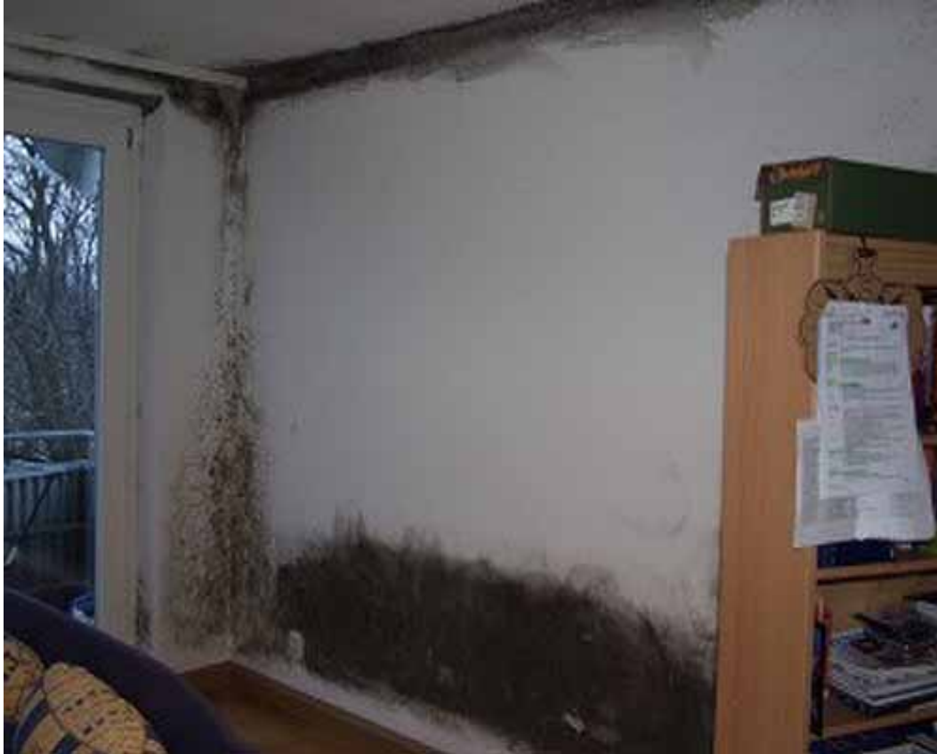
Abbildung 2: Schimmelbildung an Wärmebrücken aufgrund unzureichender Lüftung und Beheizung, Quelle: Diemer & Partner
