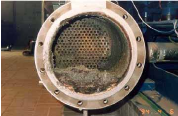
Bild 10: Ablagerungen von Sulfatasche an einem Abhitzekessel einer Biogasanlage
