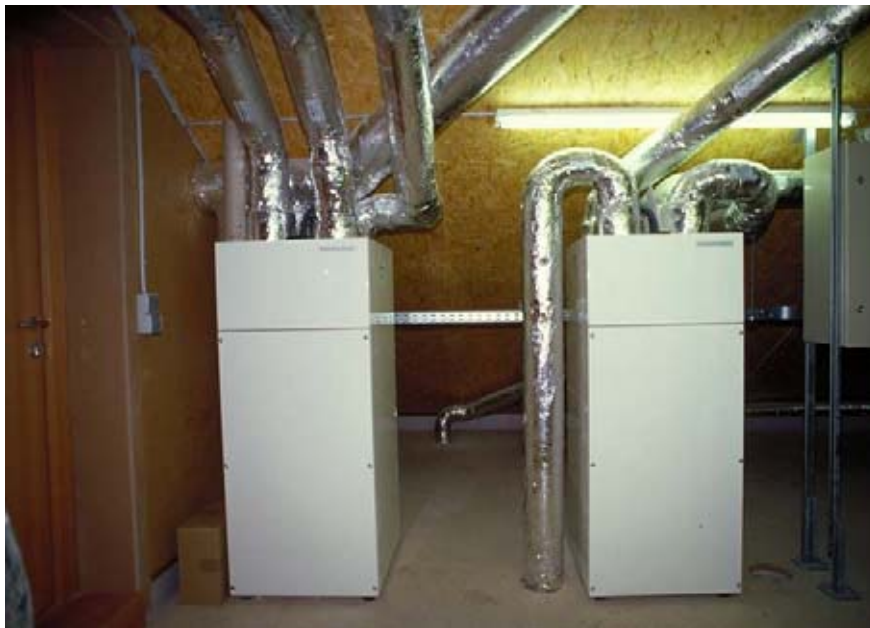
Abbildung 27: 2 AEREX-Lüftungsgeräte im Technikraum am Dachboden
