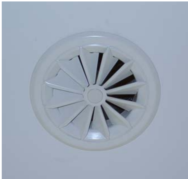
Abbildung 25: Radialauslass im Obergeschoss
