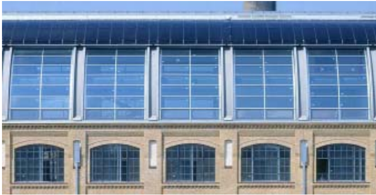
Abbildung 1: Das Tonnendach kann mit einem elektromechanischen Sonnenschutz verschattet werden. Im oberen Teil des Bildes ist der Solarabsorber zu erkennen.
