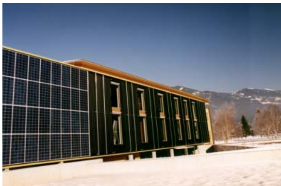
Abbildung 1: 80 m 2 fassadenintegrierte Sonnenkollektoren zur Warmwasserbereitung und zur Heizung des Bürogebäudes und der Fertigungshalle (Quelle: AKS DOMA)
