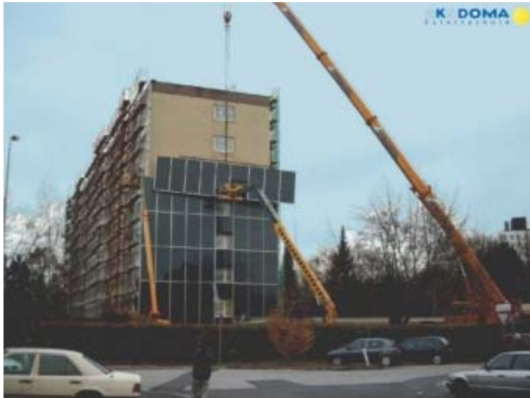
Abbildung 1: Errichtung der 240 m 2 großen Solaranlage an einem Wohnhaus in Linz, Stadlerstraße. Die Kollektorfläche besteht aus sieben jeweils 12 Meter langen Solarmodulen
