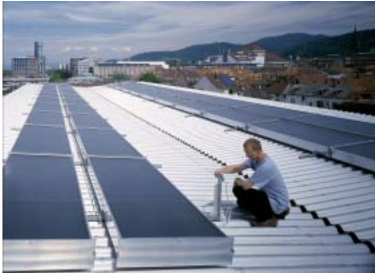
Abbildung 2: 100 m 2 Solarluftkollektoren für eine solarautarke sorptionsgestützte Klimaanlage am Dach der Industrie- und Handelskammer Südlicher Oberrhein (IHK SO) in Freiburg. Quelle: Fraunhofer ISE
