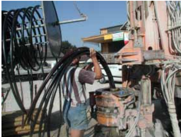
Abbildung 6: Einbringen der Tiefensonden - vier Rohre je Sonde, über das fünfte Rohr wird das Bohrloch hinterfüllt. Beim ChristophorusHaus wurde das spezielle Hinterfüllmaterial „Stüwatherm“ verwendet, das die Wärmeleitfähigkeit durch Zugabe von Quarzkorn im Vergleich zu konventionellen Bentonit-Zement-Gemischen um bis zu zehn Prozent erhöht.
