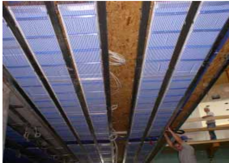
Abbildung 8: Heiz- und Kühldecken (Produkt „RCS“) im ChristophorusHaus
