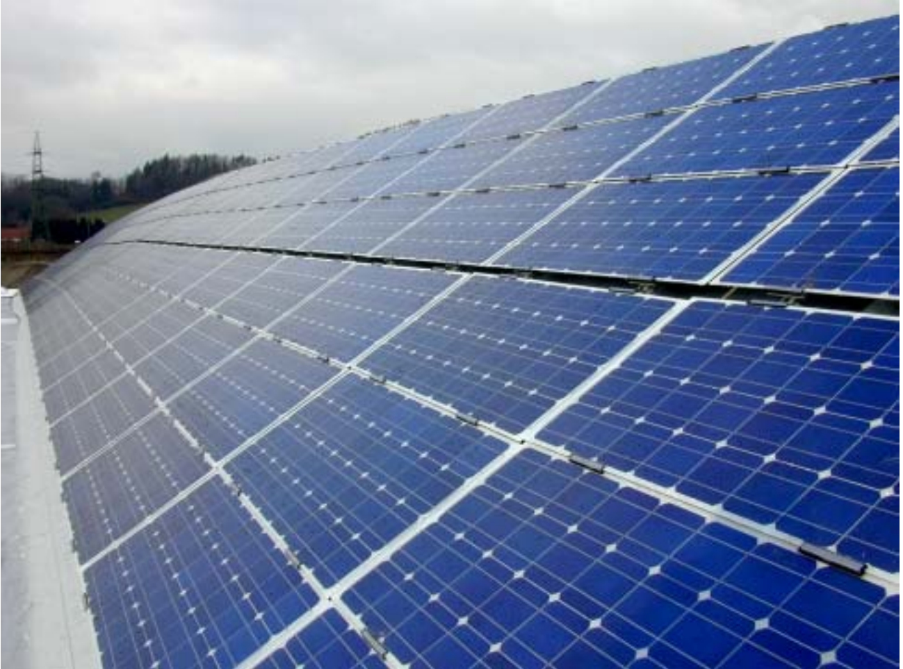
Bild 7: Größte PV-Anlage Österreichs: Green-One-Tec in St. Veit (Foto: SAG Solarstrom)
