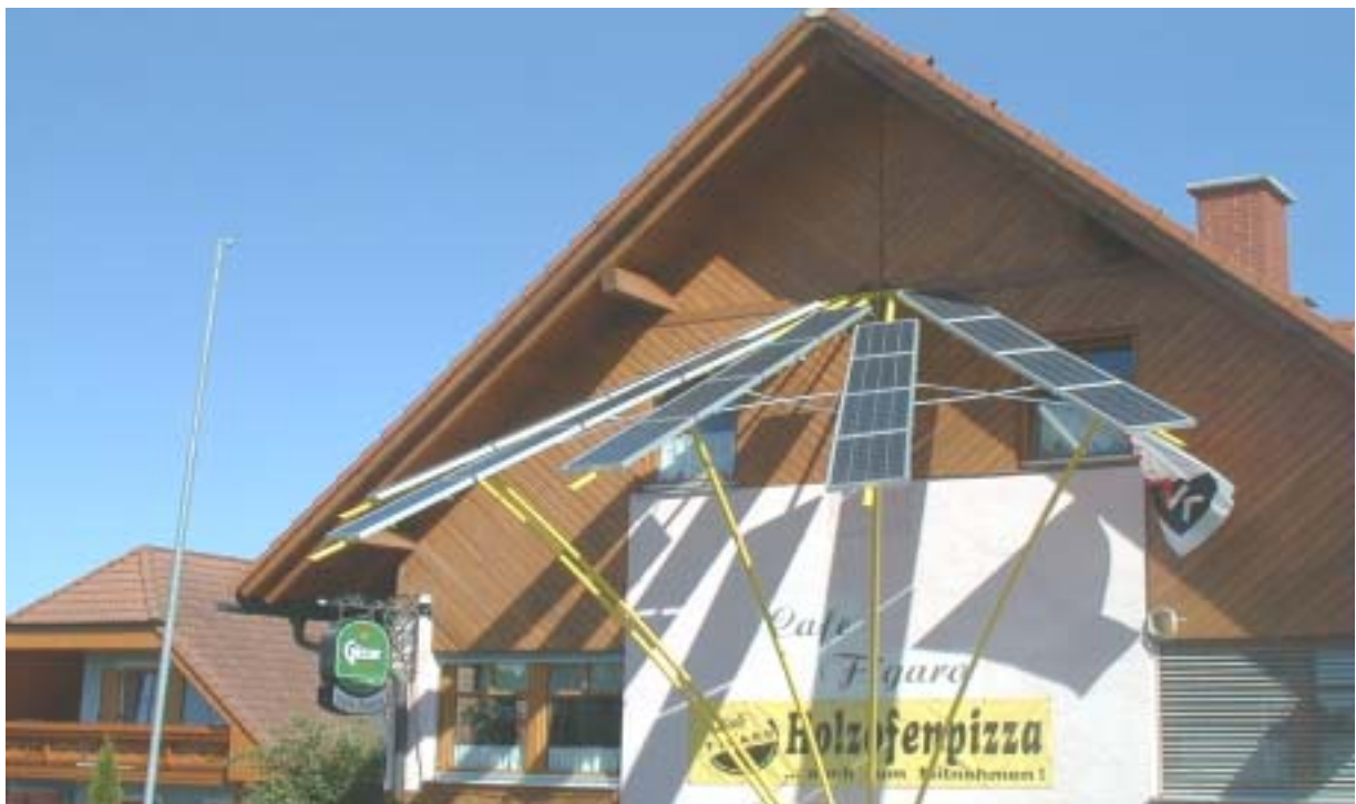
Photovoltaikanlage an der Südfassade des 1. österreichischen Solarcafes in Wünschendorf/Gleisdorf
