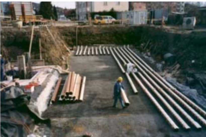
Abb. 1: L-EWT zum Heizen und Kühlen im Bürogebäude „Weizer Energie -und Innovationszentrum W.E.I.Z.“
