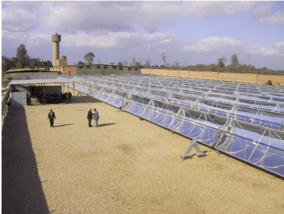
Abbildung 5: 1,33 MW th (1900 m 2 ) Parabolrinnen-Kollektoranlage für „El NASR Pharmaceutical Chemicals“ in Ägypten (Foto: Fichtner Solar GmbH)
