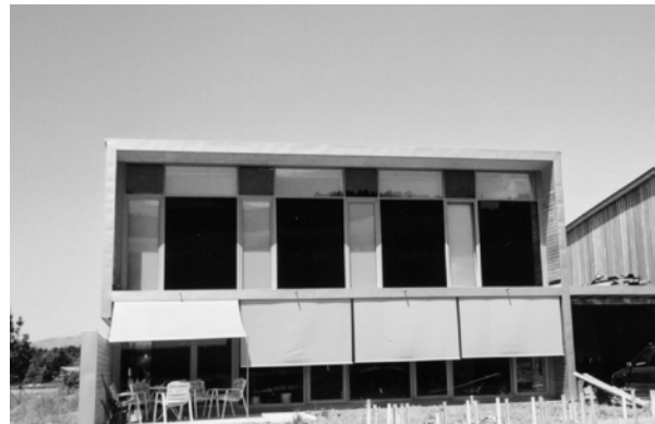
Abb.2: 28 m 2 Kollektorfläche in der Fassade eines Holzriegelbaus, Brauchwasserbereitung und Raumheizung. Die Glasabdeckleisten sind aus Holz.
