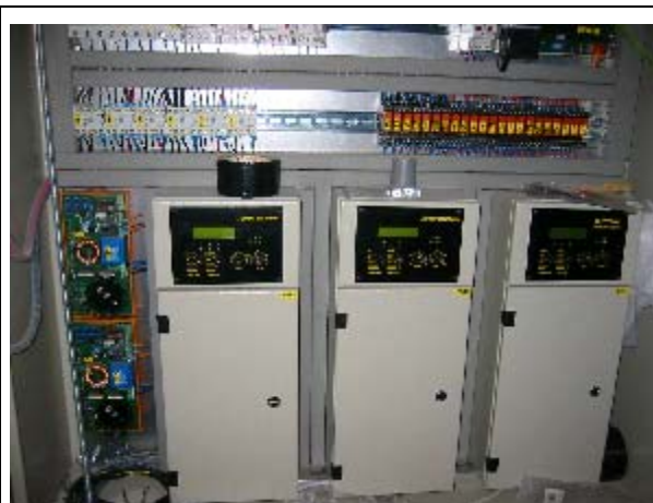
Abb. 7 - Regelungsschrank mit Fernüberwachung
