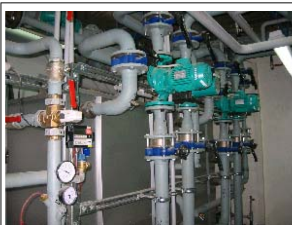
Abb. 6 - Anlagentechnik im Technikraum (Kühlmaschinen mit Pumpengruppen)
