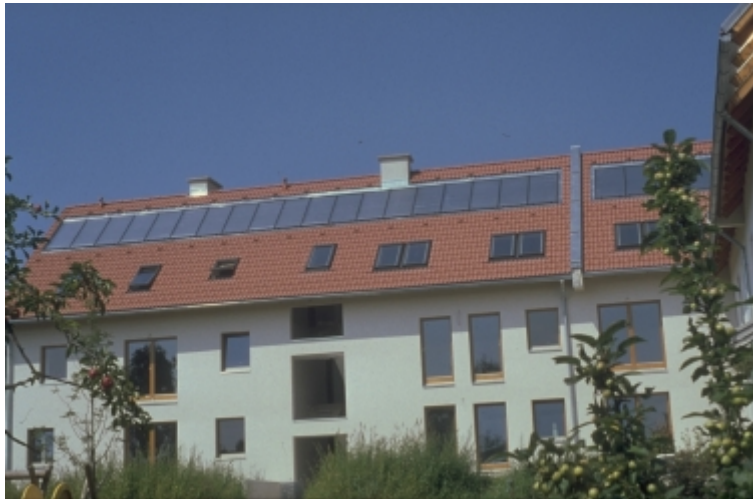
Abb. 16a: Solare Warmwasserbereitung in einem Mehrfamilienwohnhaus
