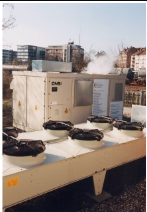
Bild 3: Brennstoffzellen-BHKW, ONSI Foto: EWAG Projekt Nürnberg
